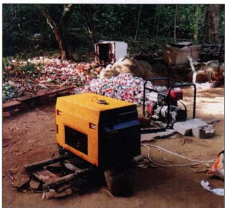
Unsere Energiezentrale stand nahe der örtlichen Mülldeponie.
