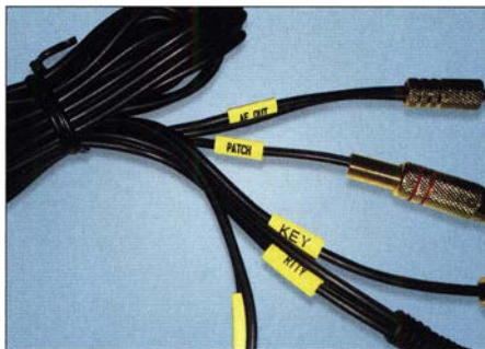
Ansicht der Transceiver-Interface-Kabel mit passender Beschriftung
